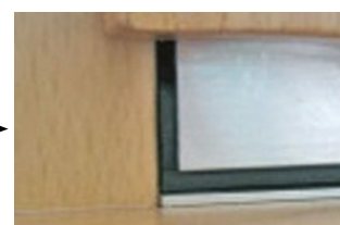
3. Дверь закрыта. Уплотнительный профиль полностью опущен и равномерно прилегает к полу.
